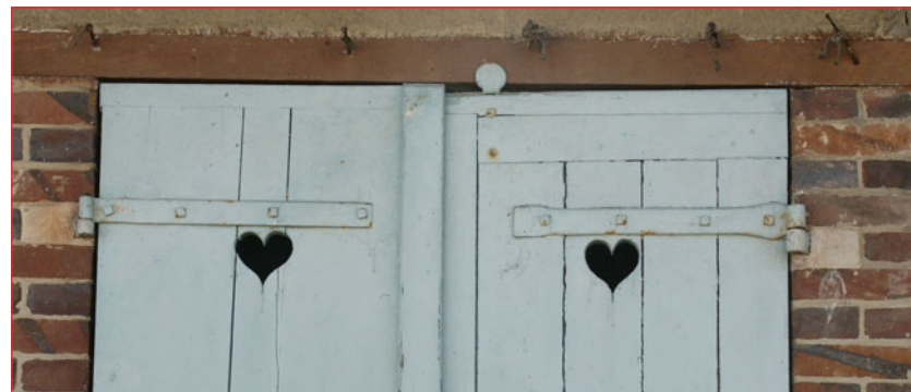
Jour de ventilation en forme de cœur
