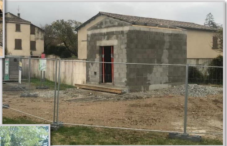
Le futur local fibre
