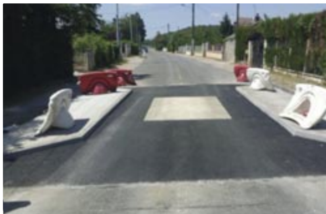
Ecluse rue André Tremblay (RD143), à proximité du chemin des Vignes
