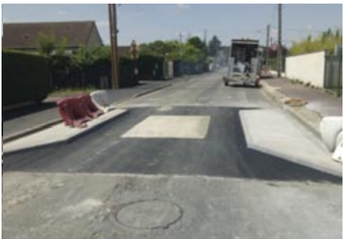
Ecluse rue André Tremblay (RD143), à proximité de la rue de la Paix
