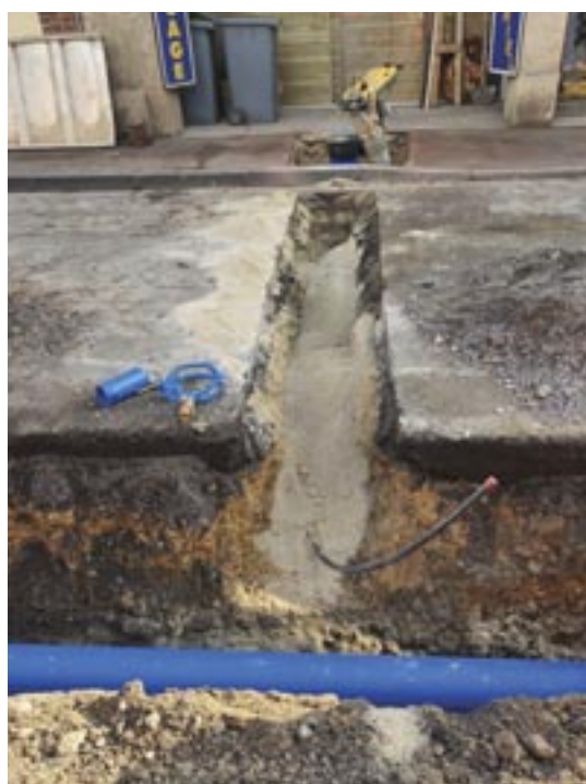
La canalisation principale d'eau potable (1er plan) et un branchement individuel
