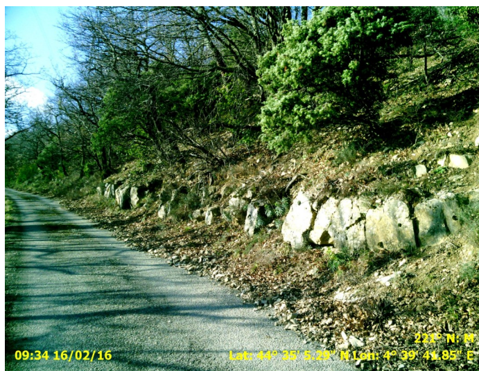
Illustration 62 : Glissement de la couverture d'altération sur les pentes moyennes
