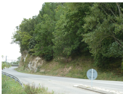
Illustration 18: Chutes de blocs le long de la route départementale 1086
