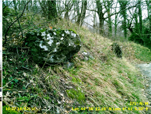
Illustration 13 : Bloc de basalte potentiellement instable sur pente
