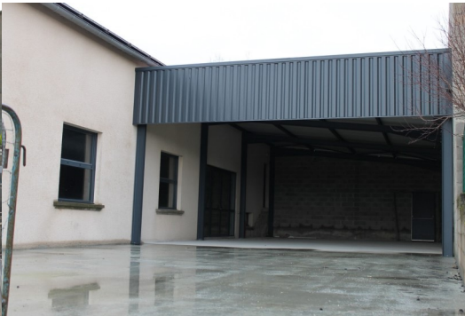
Travaux de la terrasse couverte partie Est de la salle des fêtes : De juin à novembre 2019
