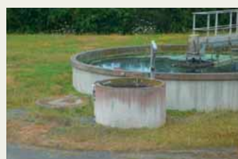
Dégazeur et clarificateur
