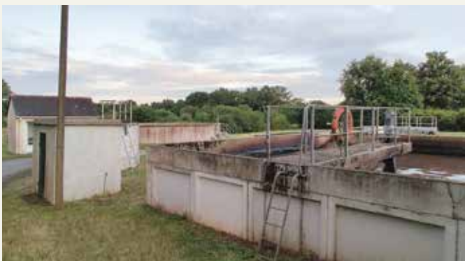
Bassin de rétention de la station de l'étang.
