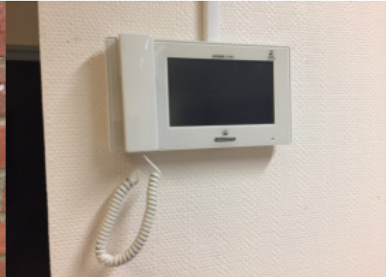
Ecole Vidéo portier intérieur Secrétariat et salle de garderie
