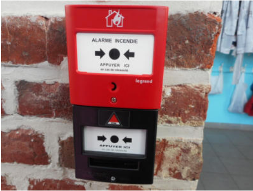
Ecole : système d'alarme incendie nouvelle alarme confinement
