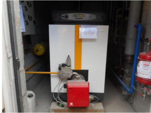
Ecole : nouvelle chaudière
