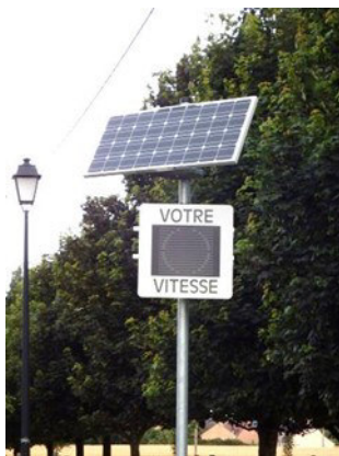
Nouveau Radar rue d'Ypres
