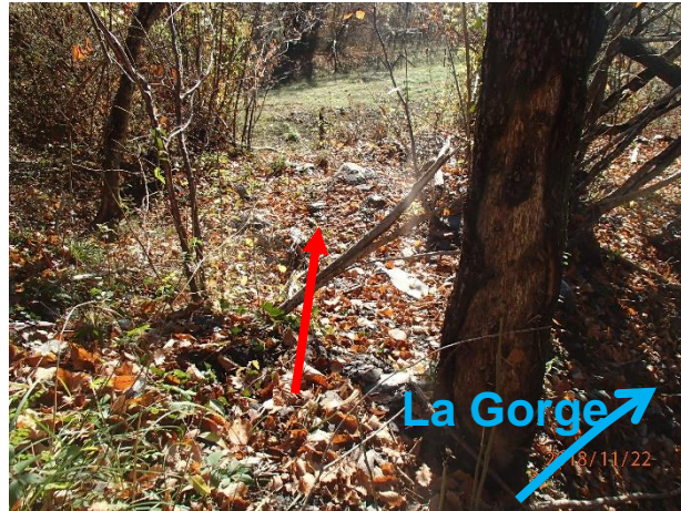
Figure 62: Traces de débordements en aval rive gauche du radier de la piste de Montplan
