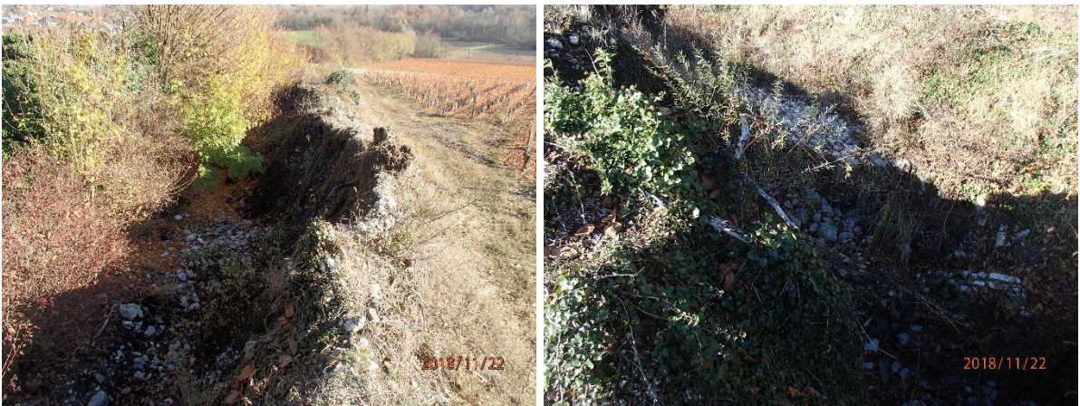
Figure 73: Anse d'érosion marquée en rive droite (à gauche) et traces d'un ancien chenal empierré (à droite)
