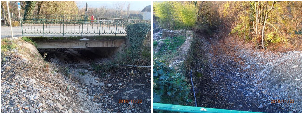
Figure 78: Pont de la RD 201 sur le torrent du Raffoux et linéaire amont sujet à engravement
