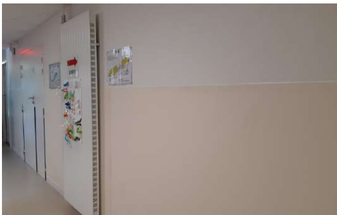
Une protection a été posée sur les murs par les agents municipaux
