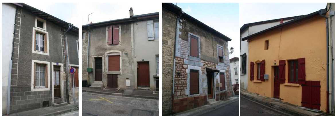
Exemples de teintes problématiques en centre historique : ciment gris, polychromie et couleurs trop saturées.
