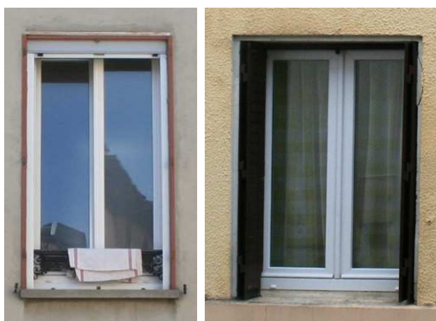
Fenêtres non-conformes sur existant en centre historique : volet roulant, châssis épais aux arêtes vives, donnant un aspect industriel assez pauvre.
