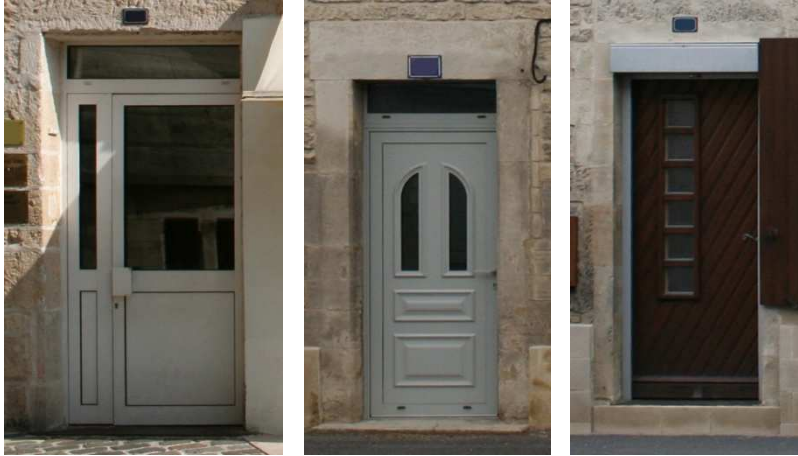
Portes non conformes en centre historique. De gauche à droite : menuiserie en PVC avec une finition industrielle, introduction de lignes courbes et biaisés dans le dessin de la porte sans justification.
