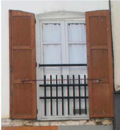
Dessin de garde-corps incohérent avec la façade
