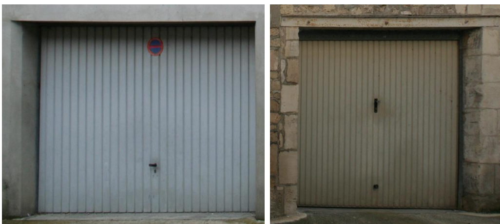
Portes de garage dévalorisantes en centre historique. Ces éléments standards s'intègrent mal dans les façades existantes.
