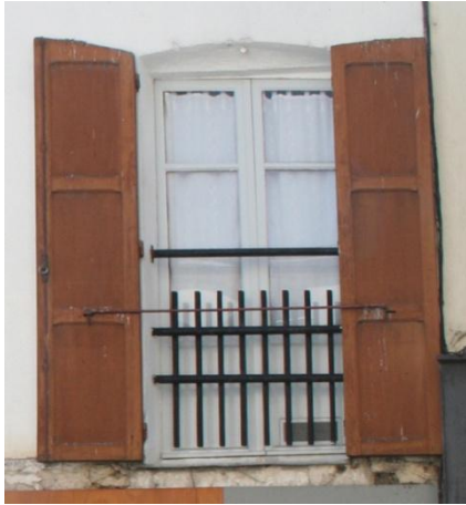
Dessin de garde-corps incohérent avec la façade
