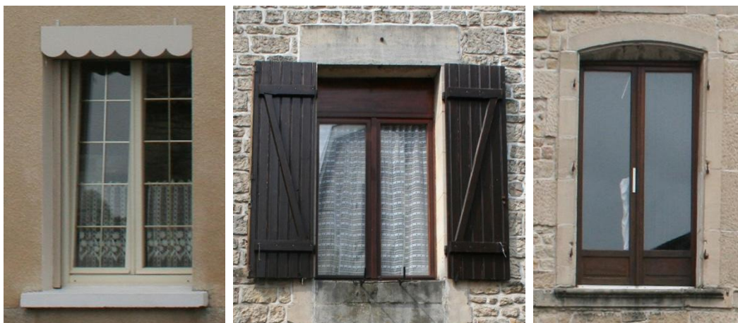
Fenêtres non-conformes sur existant, en centre historique. De gauche à droite : petits carreaux dorés à l'intérieur du verre, éléments supérieur et inférieur trop larges.
