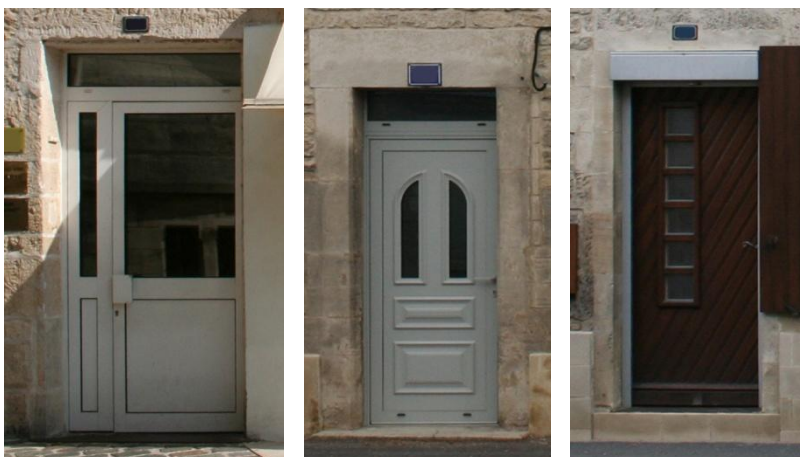
Portes non conformes en centre historique. De gauche à droite : menuiserie de PVC avec une finition industrielle, introduction de lignes courbes et biaisés dans le dessin de la porte sans justification.
