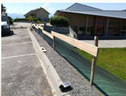
Barrières de sécurité, parking de l'école
