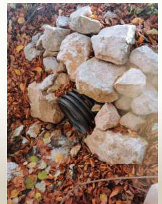
Eaux pluviales à Marigny
