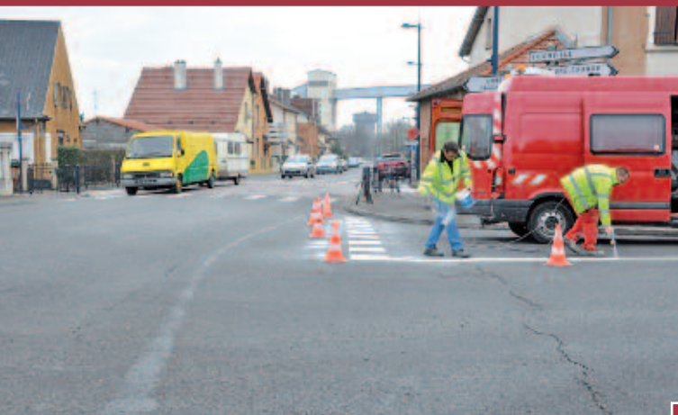
Marquage de sécurité rue Poincaré.
