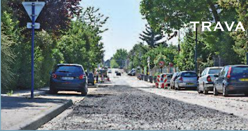
Enfouis sous la tranchée récemment refermée, des centaines de mètres de nouvelles canalisations
