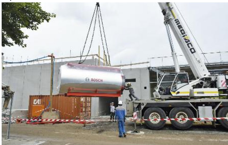
Livraison de la chaudière gaz
