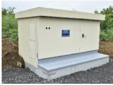
La rue de Guissebonne bénéficie elle aussi d'un nouveau transformateur....
