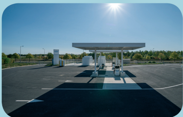
GUICHAINVILLE - Plateforme Engie
