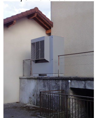
la PAC installée en juin
