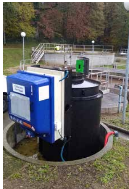
Station de Ponthévrard-Poste de traitement
