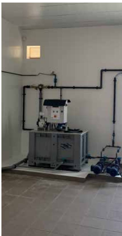
Poste de préparation du polymère
