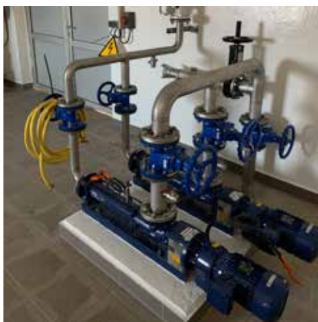
Zone de pompage
