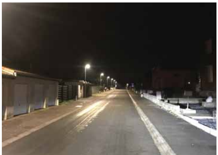
L'éclairage public a été modifié dans huit rues de la commune. Des ampoules à LED ont été installées permettant une économie d'énergie et une meilleure qualité de luminosité.
