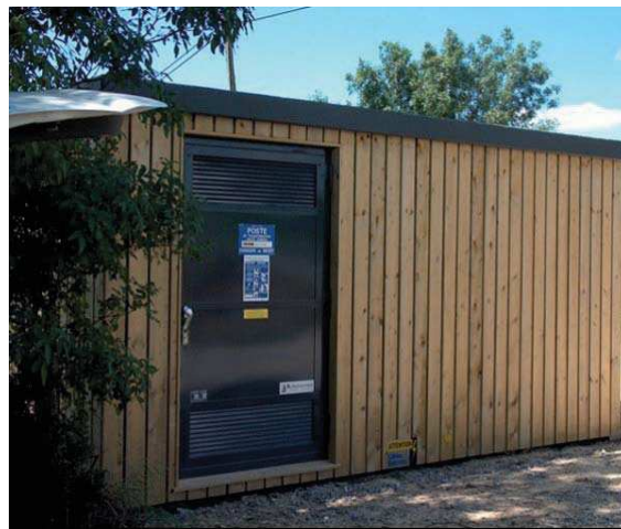
Exemple de transformateur électrique autorisé
