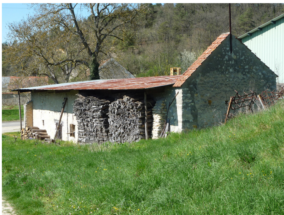
Source : photo J-P DENUC. Un bâtiment qui risque de disparaître
