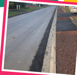
Mise en place de réseaux de drainage pour les eaux pluviales chemin d'Aubigny et rue des Saules
