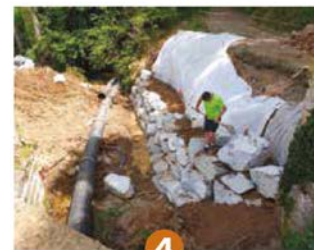
4 En pied de berge des enrochements assureront sa stabilité lors de prochaines crues
