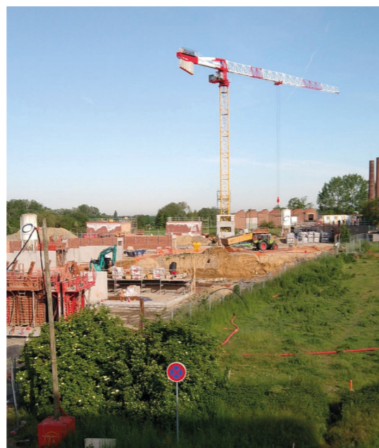
Écoquartier de l'Ange gardien : les travaux de construction des 84 logements de la phase 2 ont démarré le 14 décembre 2020. Les entreprises de gros œuvre devraient être sur place jusqu'au mois de novembre.
