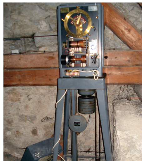
L'ancien mécanisme de l'horloge, qui a été remplacé.
