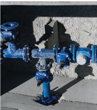
Chambre de répartition pour les différents départs et la pose de compteurs de mesure intermédiaires
