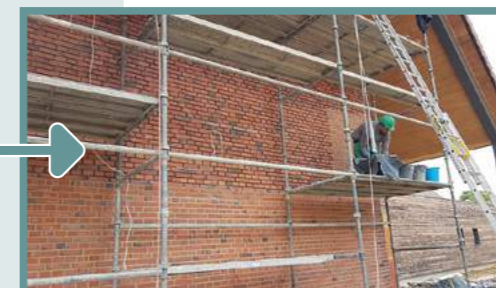
Parement de la façade (été 2021) avec des briques en provenance de la briqueterie Dewulf à Allonne. Appareillage Picard ou en losange.
