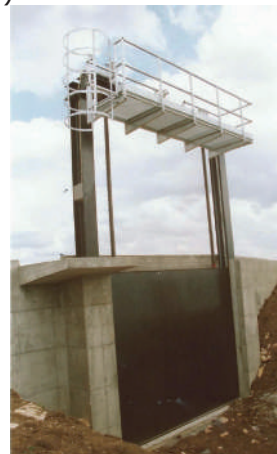
Une des trois vannes
