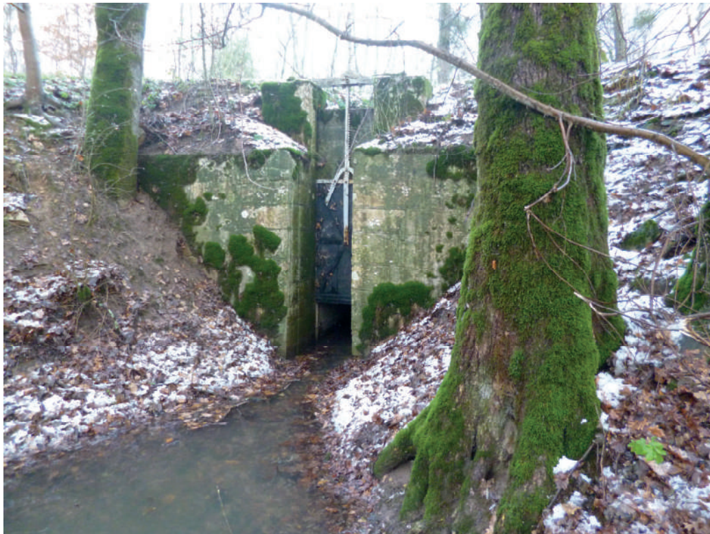
VANNE « Terre du Canard » Située au nord du chemin des Léchères C'est la plus importante car elle absorbe les flux pluviaux du versant nord-ouest de la commune.
