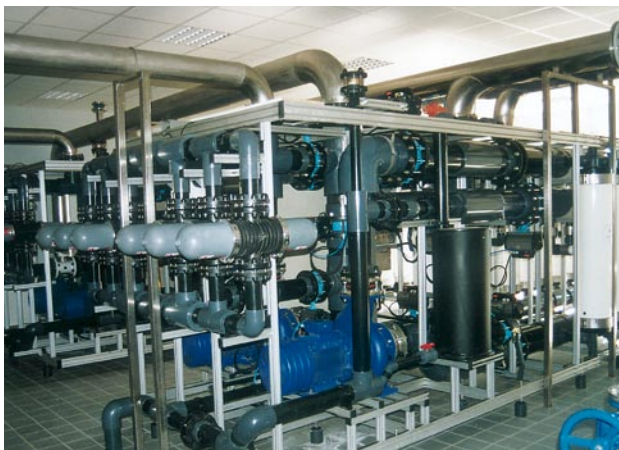
Station d'ultrafiltration d'Ébey sur la commune de Belleherbe..
