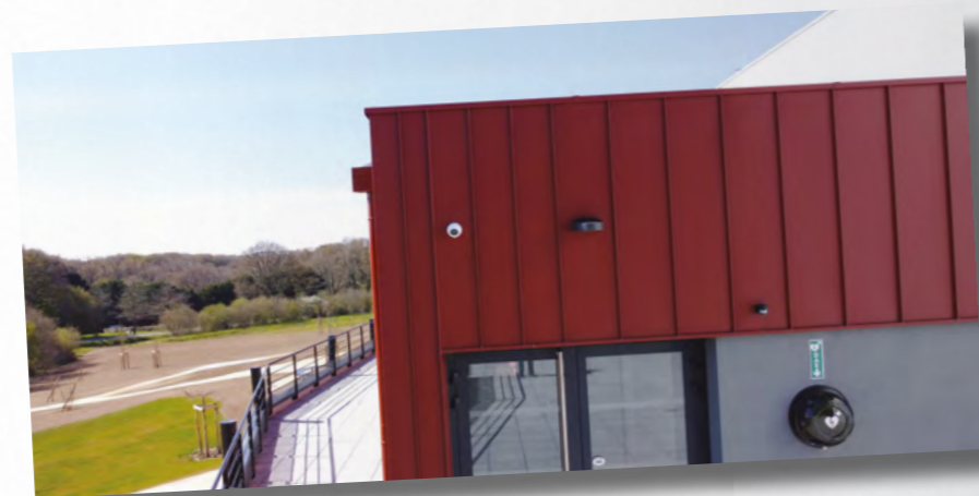
Pose des caméras de télé-surveillance au pôle sportif
