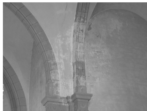
Les peintures sont dégradées
