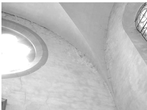
La voûte est fendue
