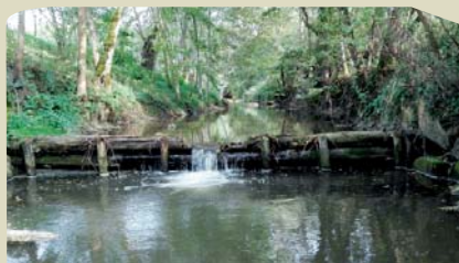
Ouvrage infranchissable de 60 cm de haut
