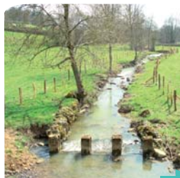
Berges juste après la pose de clôture sur le Bézo à Ligny-en-Brionnais (71)
