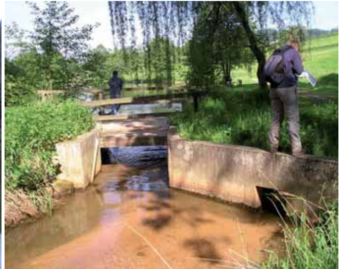
Prise d'eau aménagée sur un étang
