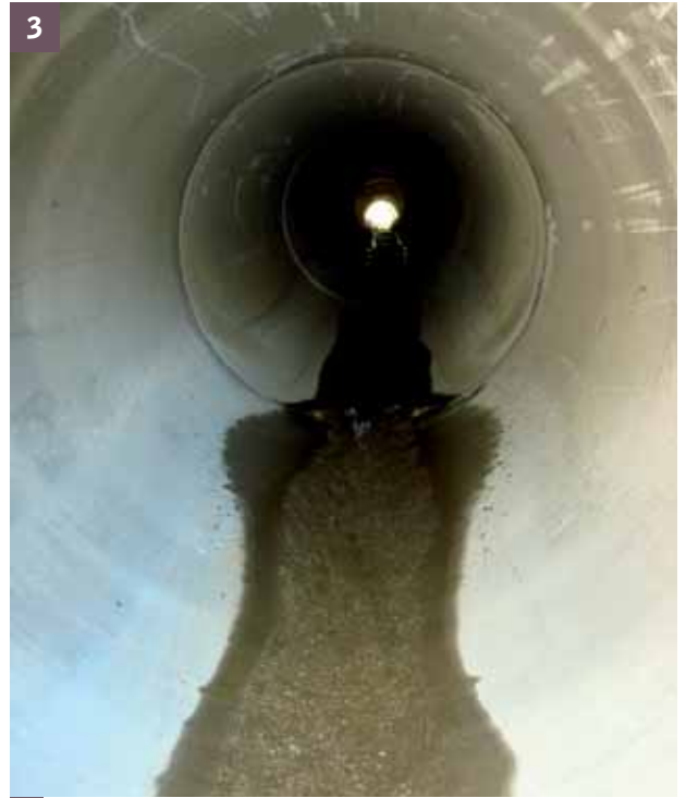
3 La faible lame d'eau ainsi que les vitesses trop élevées empêchent le déplacement des poissons
