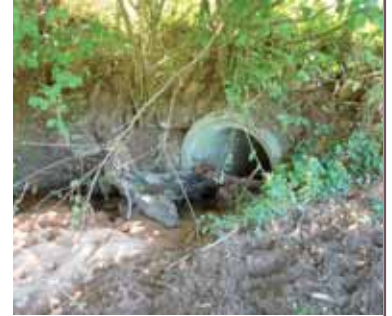
Blocage à l'entrée du busage
