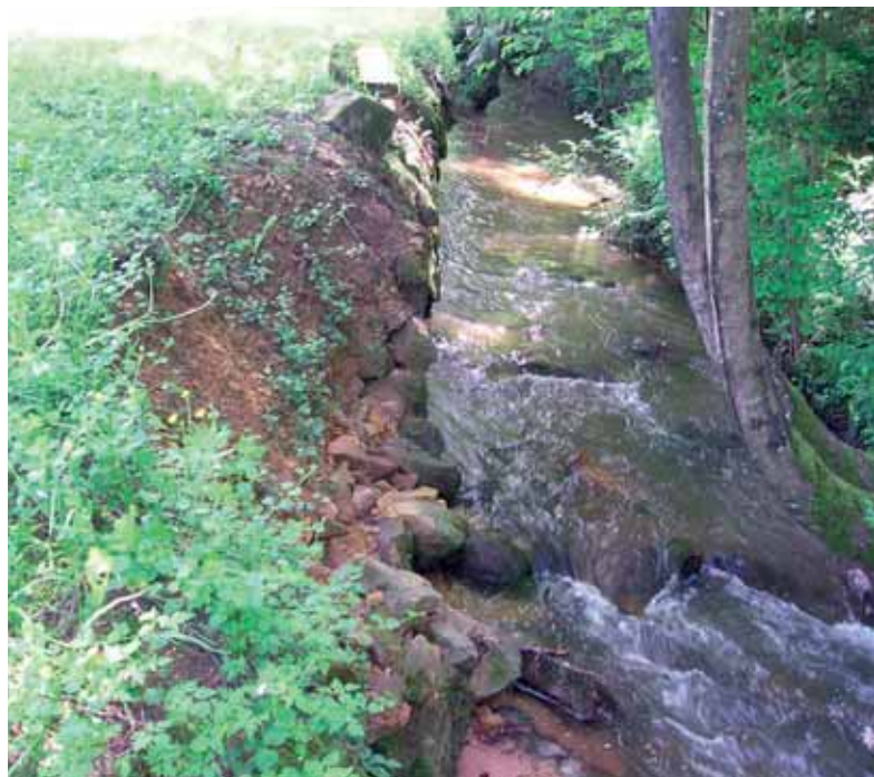
Érosion de berge liée à un fort débit accentué par sa chenalisation
