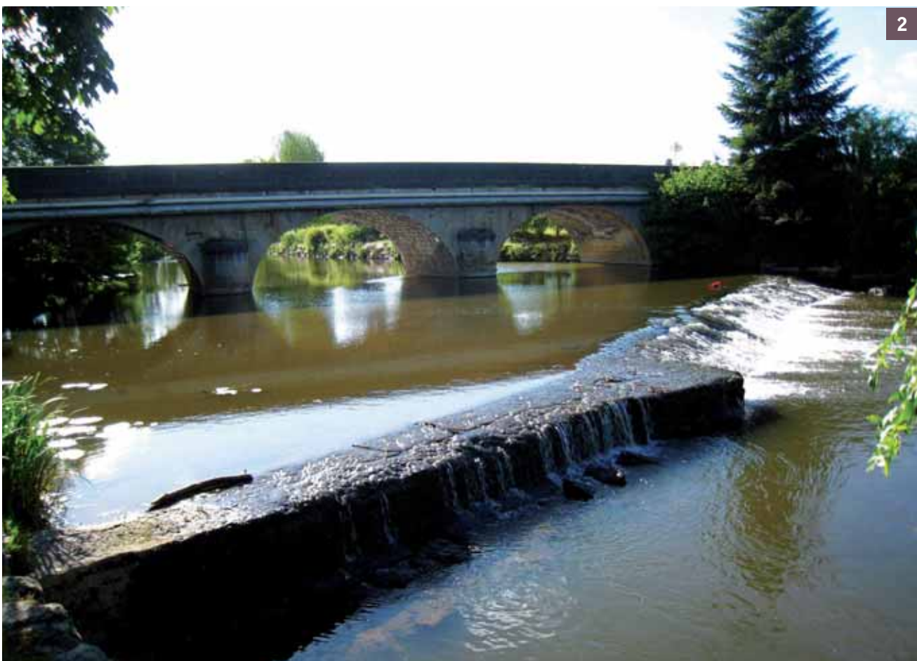
1 et 2 Surdimensionnement du lit, homogénéisation des faciès d'écoulement dans la retenue d'un seuil, début de développement d'algues et d'eutrophisation du milieu
