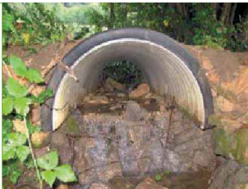
L'accélération de l'eau liée ici au sous-dimensionnement de l'arche a causé son ensablement, son comblement et une érosion à l'aval
