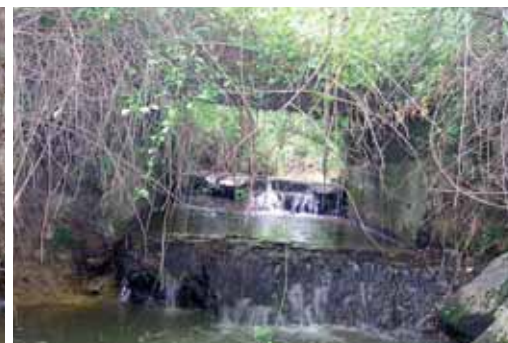
Érosion à l'aval et début d'affouillement du radier et au blocage des sédiments
