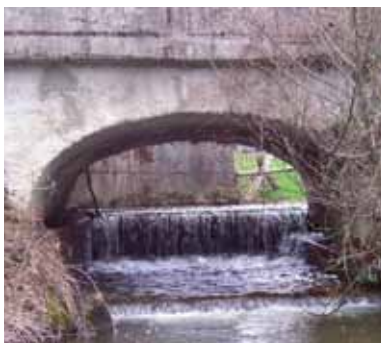
Infranchissabilité et lame d'eau trop faible pour assurer la nage de tous les poissons
