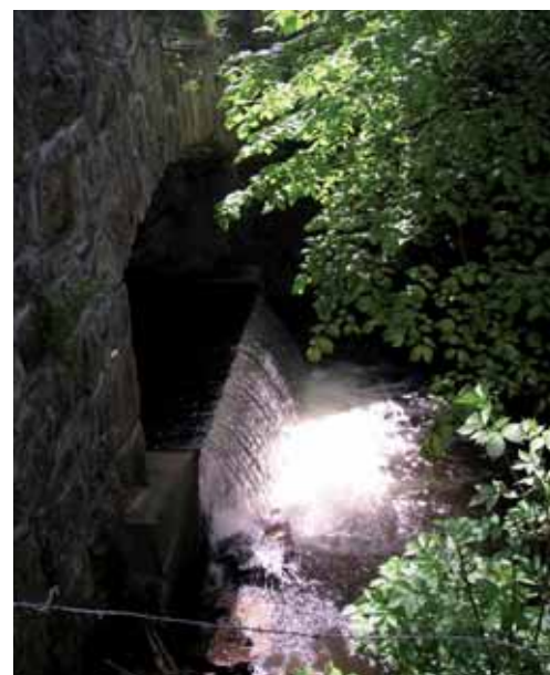
Infranchissabilité et lame d'eau trop faible pour assurer la nage de tous les poissons
