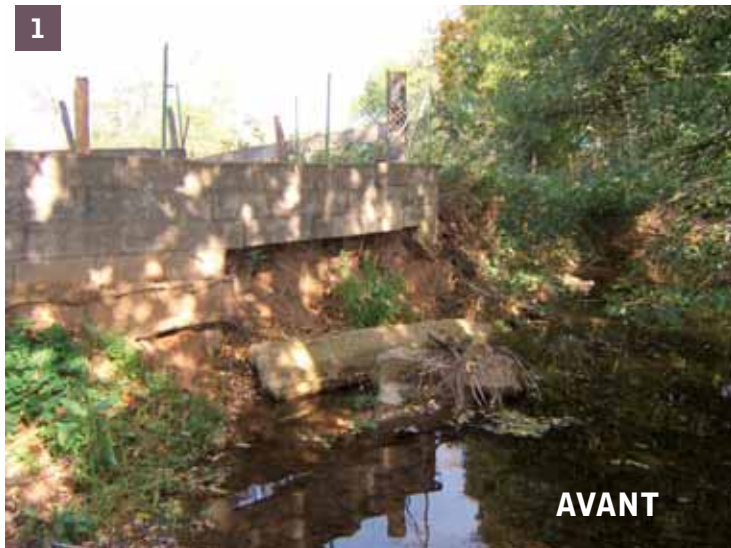
1 Avant : construction d'un mûr trop prêt dans le lit de la rivière
