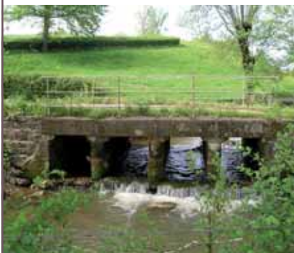
Enfouissement trop faible des buses
