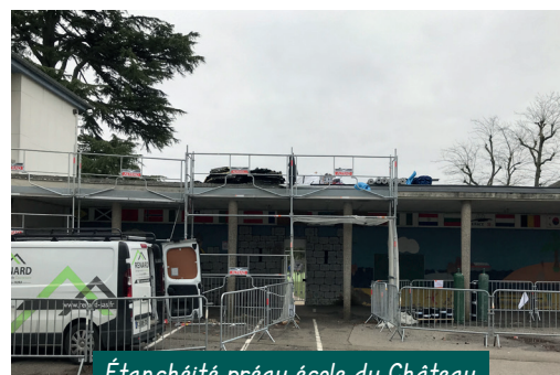
Étanchéité préau école du Château
