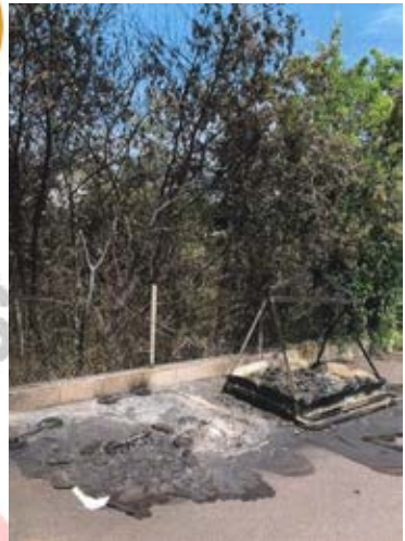
dégradations juillet 2021 : bacs et macadam brûlés
