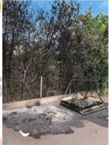
dégradations juillet 2021 : bacs et macadam brûlés
