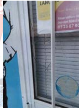
dégradations février 2022 : vitre cassée
