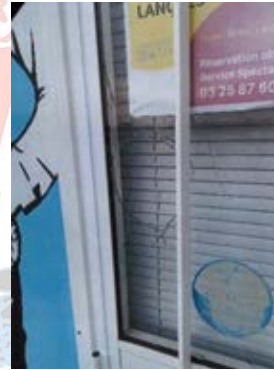
dégradations février 2022 : vitre cassée
