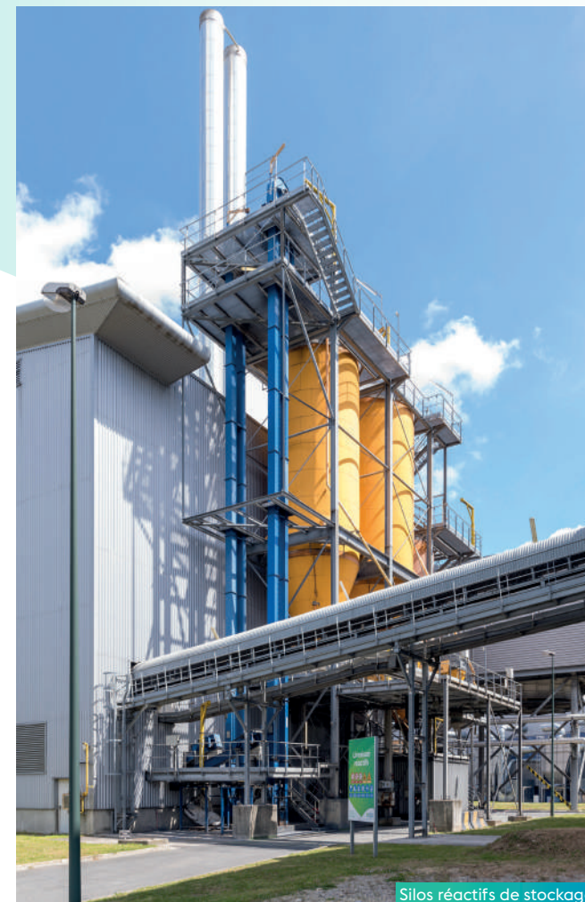
Silos réactifs de stockage
